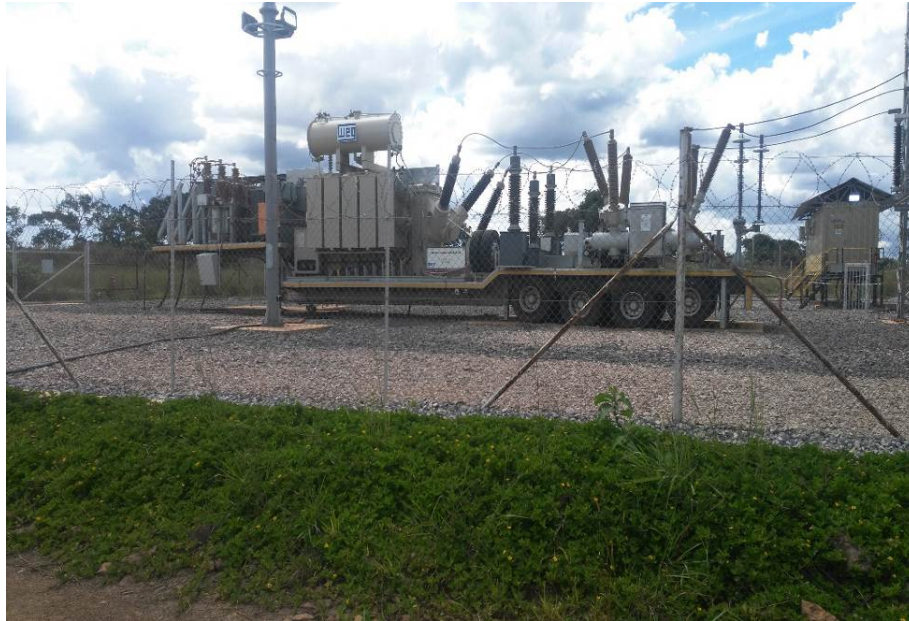
Photo 4: La station électrique Basse tension de Kakula
